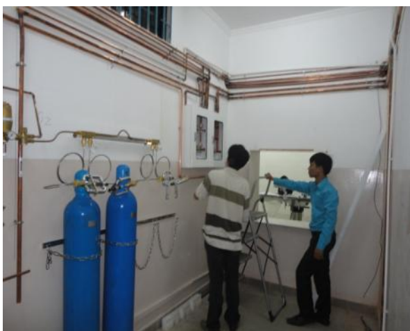
ガス中央制御室の様子 (2013年7月)
