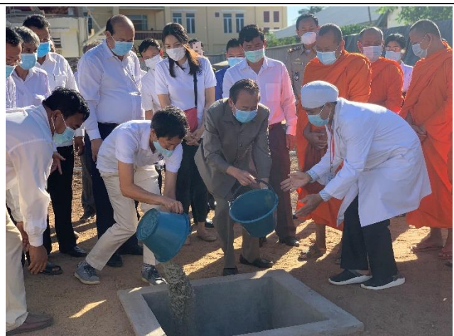
1-3-2 外科棟の移転建設 着工式 クラチェ州知事、州保健局、州病院、FIDR
